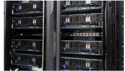
NVIDIA® Tesla® V100を8基搭載するNVIDIA DGX-1™は、データセンターに設置されている
