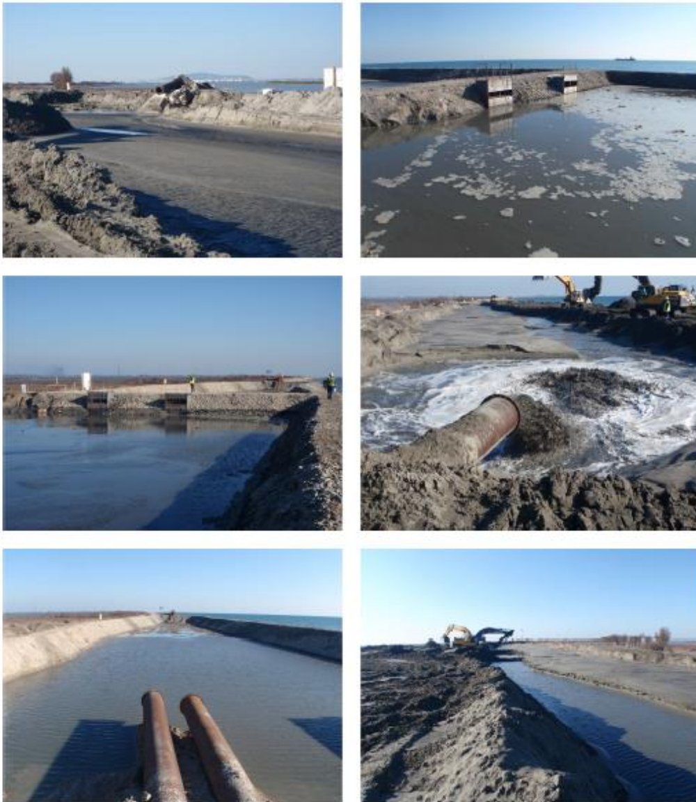
Fig.3 Bassins de décantation. Source DREAL
