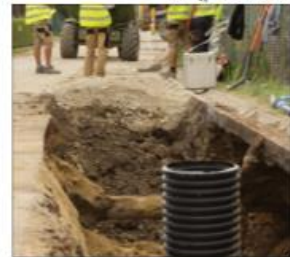
Będziemy także kontynuować prace kanalizacyjne w Mrowinach i przy ul. Słowiańskiej w Żarowie.
